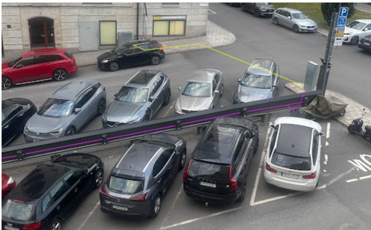
Figur 4.2: Kungsholms kyrkoplans laddstation med 34 laddpunkter fördelade på två sidor om vinkelställd parkering. Streckad linje är ledning under jord och heldragen ovan jord i balken. Lila linje är laddoperatörens kabel och gul är nätägarens.
