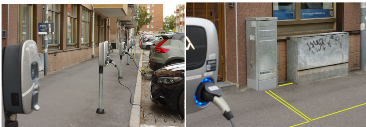
Figur 4.1: Starrbäcksgatans laddstation med traditionella laddstolpar. Höger: schematisk bild över hur mätarskåp är anslutet till nätägaren Vattenfalls elskåp och vidare fördelning till laddstolpar under jord.
